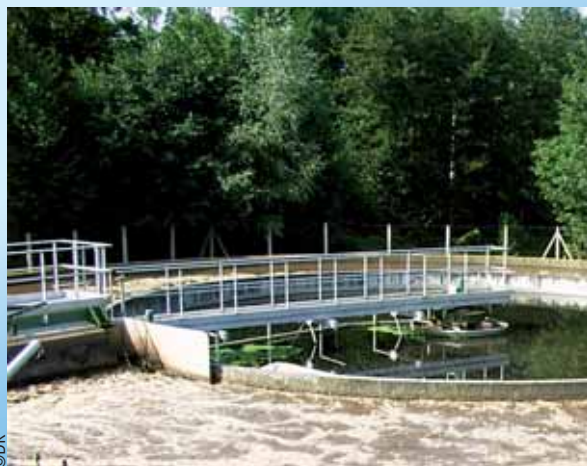
Station boue activée (bassin d'aération + clarificateur)
