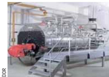
Chaudière de production de vapeur
