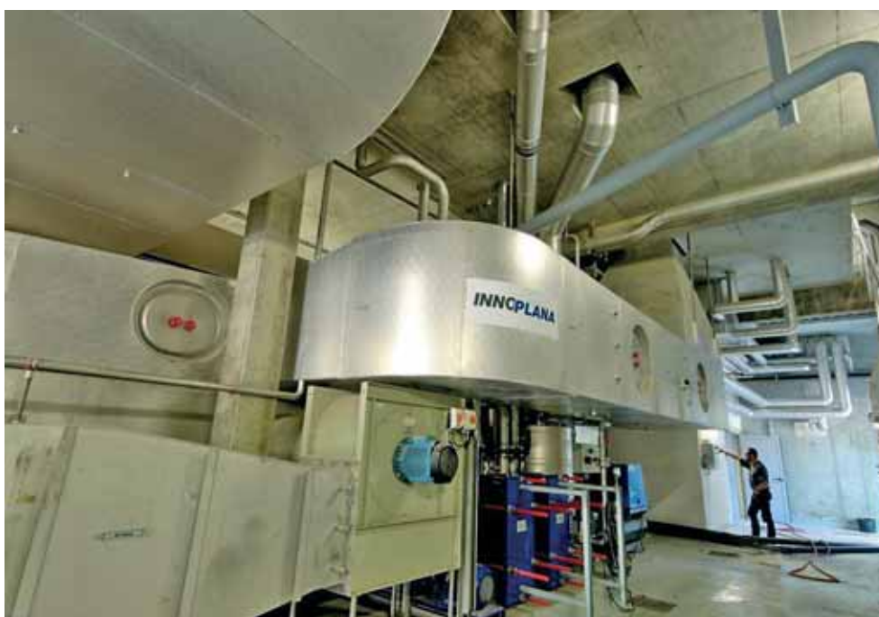
Cap Ferret - Sécheur Innoplana - développé par Degremont
