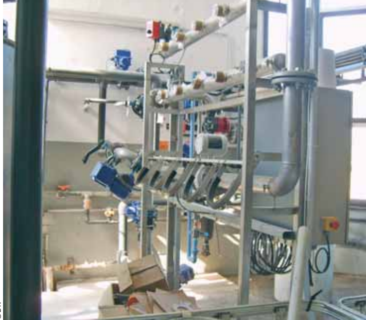
Installation de déferrisation des eaux traitées sur la station d'épuration de Le Touquet
