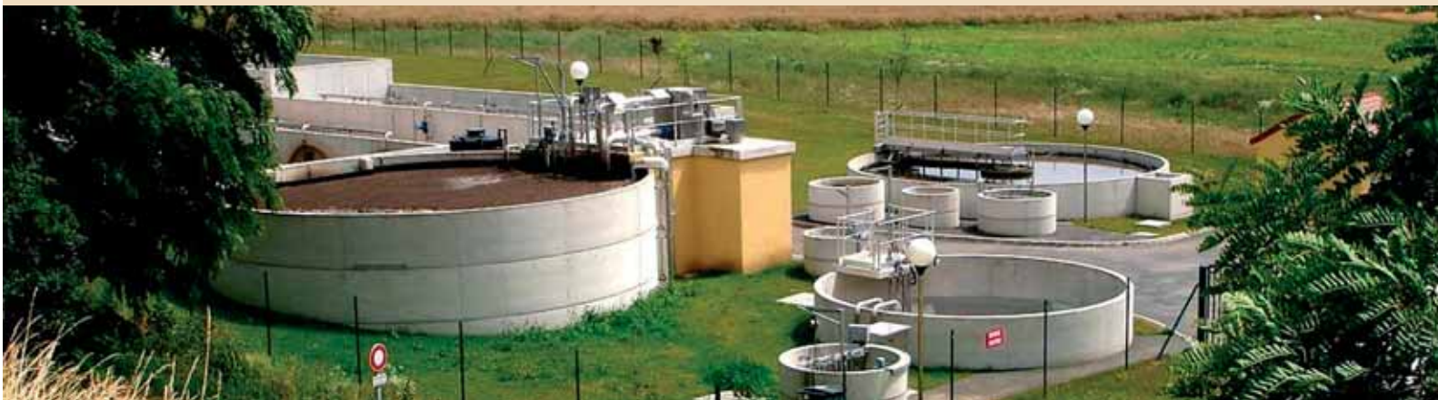
Station d'épuration de RICHEBOURG (78)
