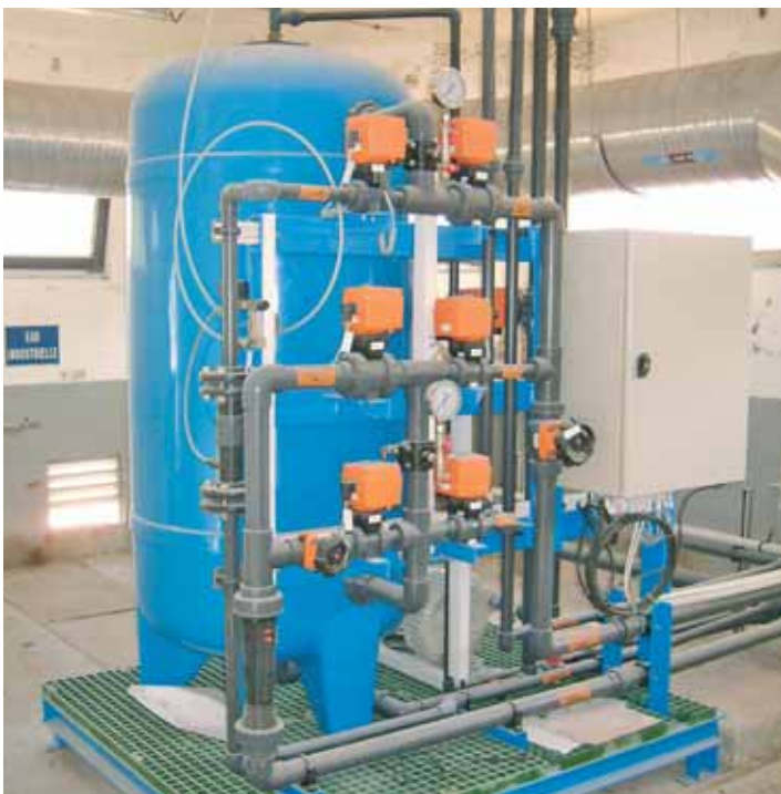
Installation devant recevoir une unité membranaire pour obtenir une eau d'excellente qualité à partir des eaux traitées sur la station d'épuration de LE TOUQUET.
