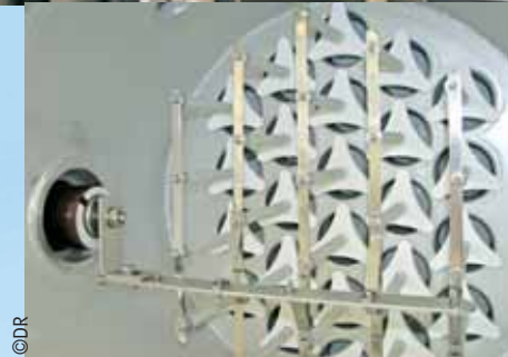
Générateur d'ozone, connexion des tubes diélectriques avec fusibles de protection
