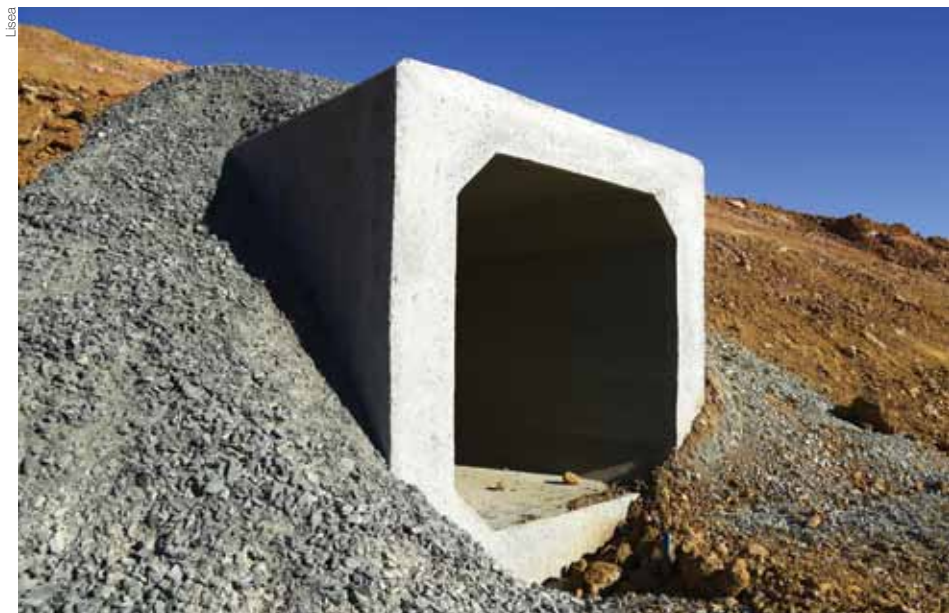
Des ouvrages de continuité écologique (tunnels, passages busés...) sont mis en place pour assurer le franchissement de la ligne LGV-SEA.
