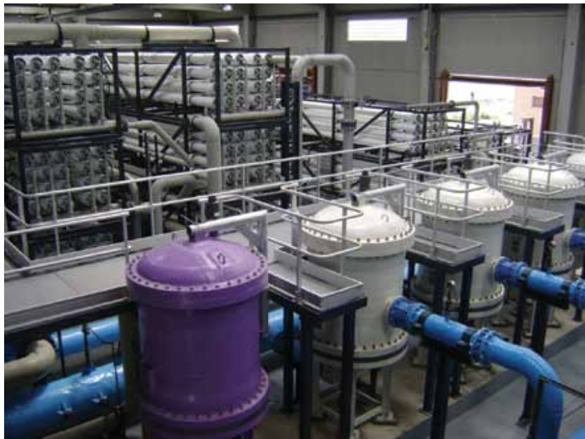
La station d'épuration de Vila-Seca a été équipée d'un traitement tertiaire par osmose inverse pour rendre possible une réutilisation des eaux usées traitées à des fins industrielles.
