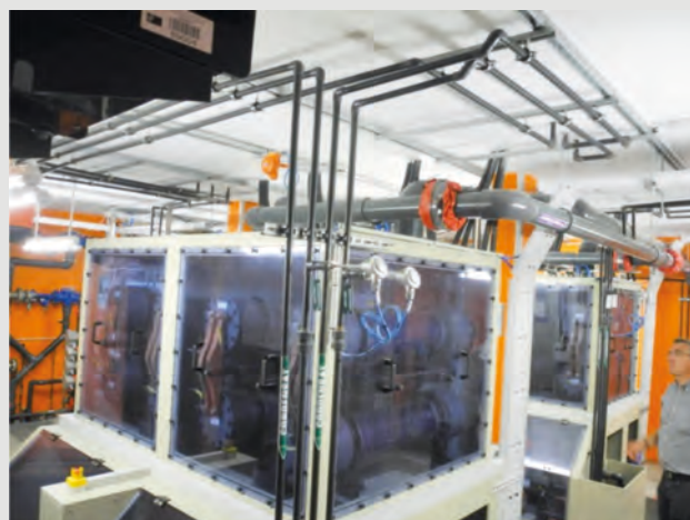
Figure 2 Installation SELCOPERM de l'usine de production d'eau potable de Choisy-le-Roi.
