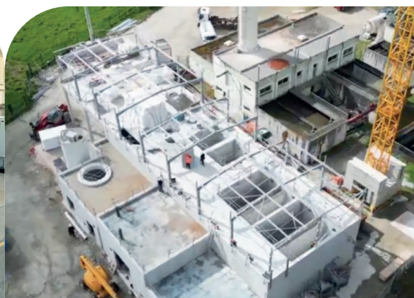
Usine d'eau potable de Toulreincq à Gourin (56)
