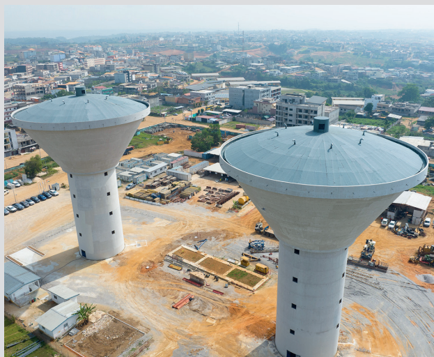
Projet Lagune d'Aghien - Abidjan - Côte d'Ivoire : châteaux d'eau de 5000 m 3 chacun
