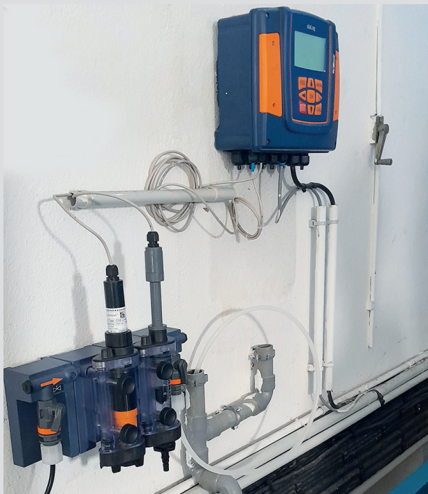
Poste de mesure de chlore dans une station d'eau potable
