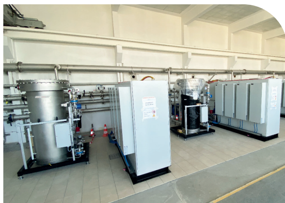
Usine d'eau potable de Choisy-le-Roi (94)
