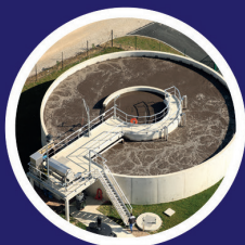
💧 Bassin de décantation
